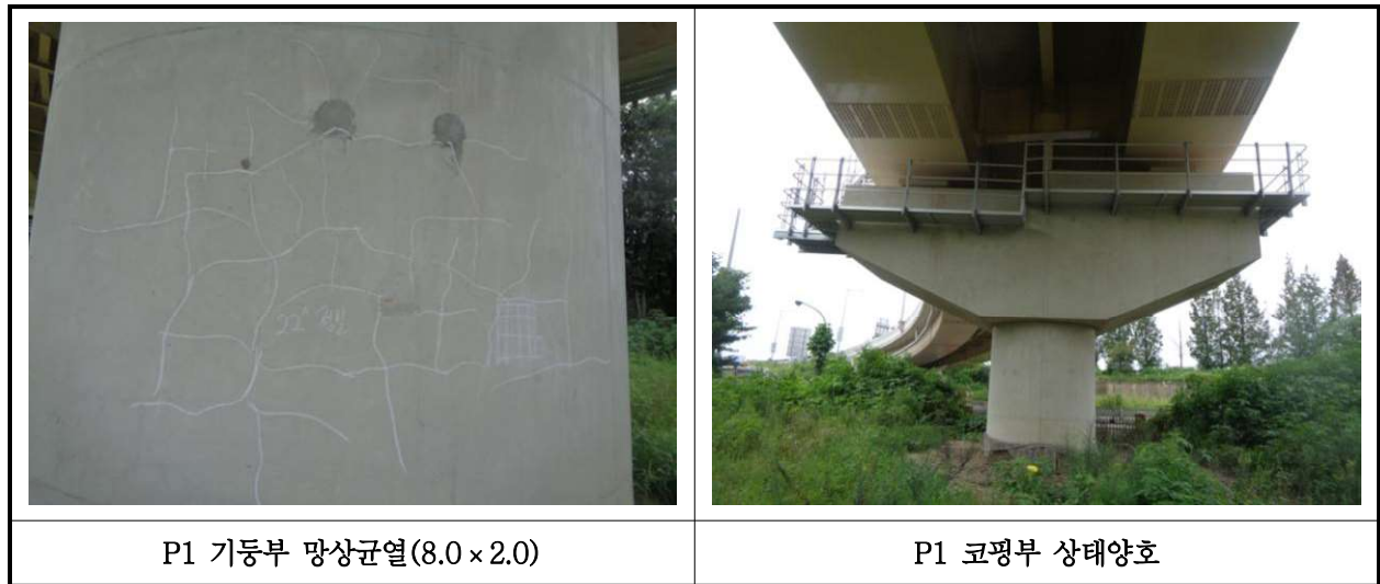
【사진 17.3.11】 교각 손상현황
